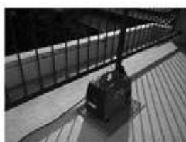
2階に常備する発電機 容量:1kwh
